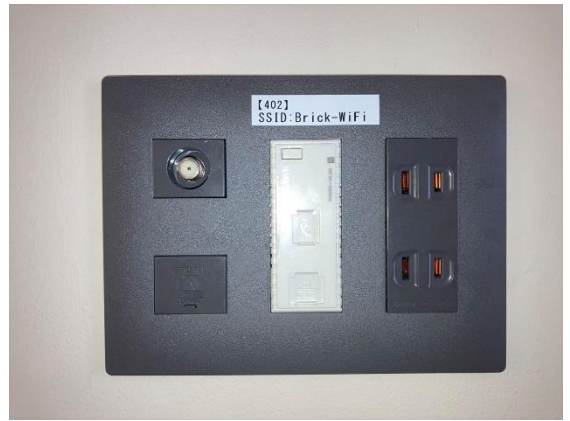
客室Wi-Fi(テレビモニター裏)
